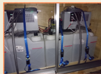
燃料電池発電装置（屋内）
