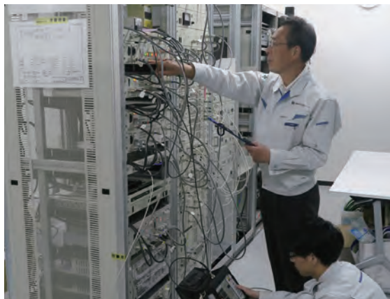
放送設備の定期点検、緊急点検など
