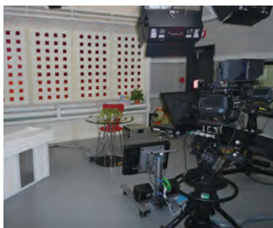
ケーブルテレビスタジオ設備
