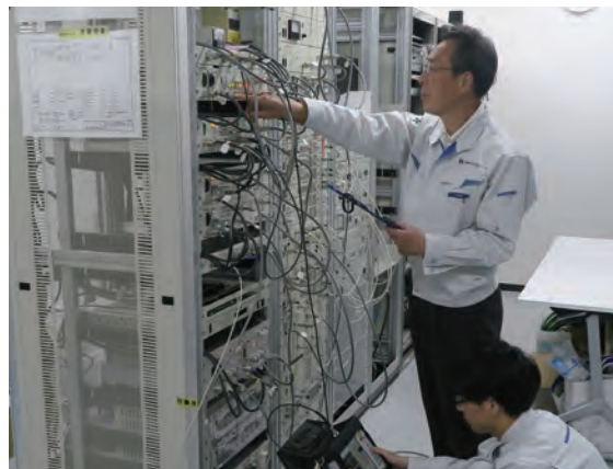
放送設備の定期点検、緊急点検など
