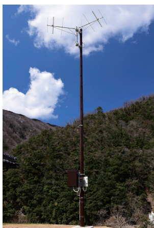
日本初のラジオギャップフィルターシステム (兵庫県香美町)設計・施工・保守
